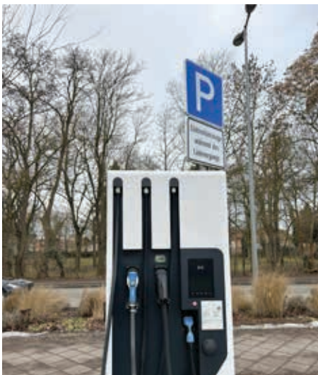
Die noch vorhandene E-Schnellladestation auf dem Parkplatz am Busbahnhof in Sömmerda funktioniert bereits seit einiger Zeit nicht mehr. Ein neuer Betreiber will sie ersetzen.
