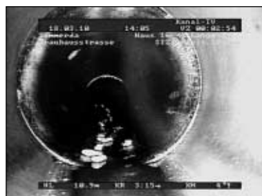
Unerlaubte Abfallentsorgung über die Kanalisation: Speisereste (hier: Pommes Frites) - Beste Bedingungen für Wanderratten
